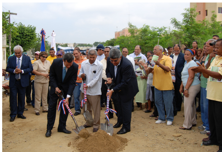
El presidente del FONPER mientras daba un palazo simbólico para dejar iniciada la instalación de un sistema de alcantarillado sanitario en La Cruz de Mari López, Santiago
